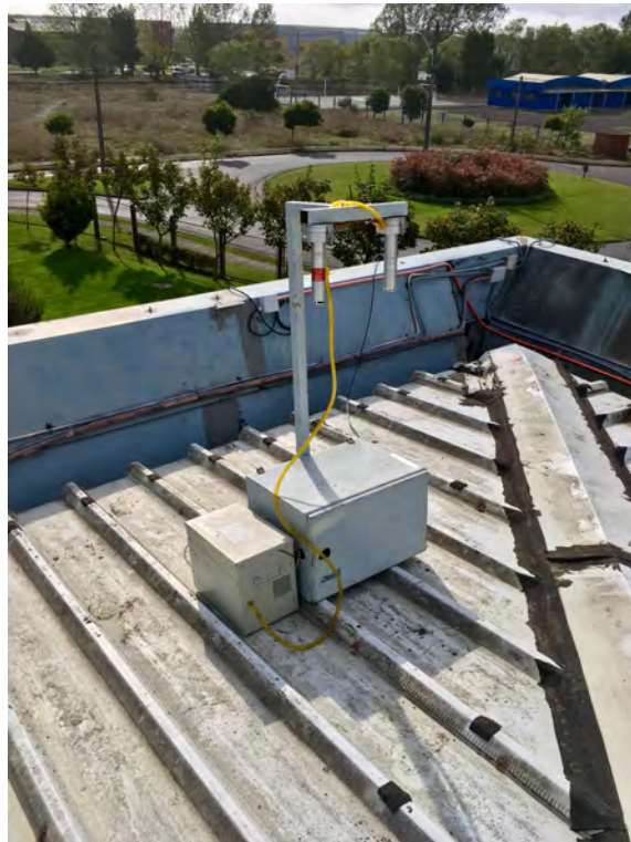
Figura 2.18. Vista del equipo KFG, instalado en el techo del laboratorio de UDT
