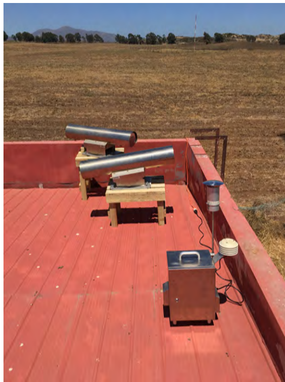
Figura 2.11. Fotografía de la instalación del equipo KFG en el techo de la estación de antenas.
