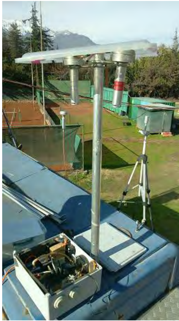
Figura 2.5. Equipo HI en el techo de la estación Las Condes
