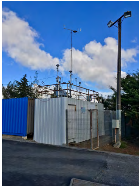
Figura 2.15. Estación de monitoreo Kingston College donde se instaló el equipo discreto de material particulado
